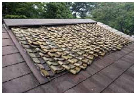
2018年9月4日 台風21号によりずれ落ちた屋根瓦
